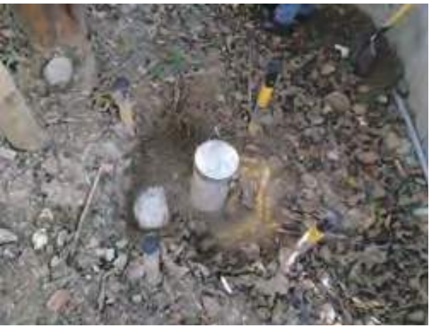
▲區域性監測井外觀損壞及異常狀況
